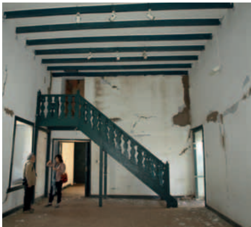
Foto 10: Vista de los daños en una de las salas de la Casa del Pilar de Esquina de Rancagua.
