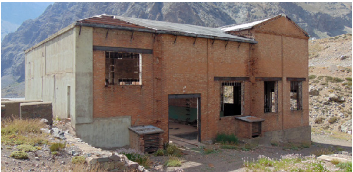
Figura 9. La subestación eléctrica del Juncal fue reconstruida en 1966, con motivo del XIX Campeonato Mundial de Esquí Alpino, realizado en la localidad andina de Portillo (Fotografía: Urzúa, C. 2016).
