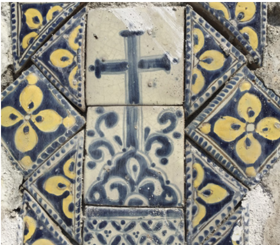
Figura 5. Deterioros observados en azulejos de talavera de los nichos del Vía Crucis, Templo de San Antonio, Centro histórico de la ciudad de Puebla, México (Fotografía: Hernández, A. 2017).
