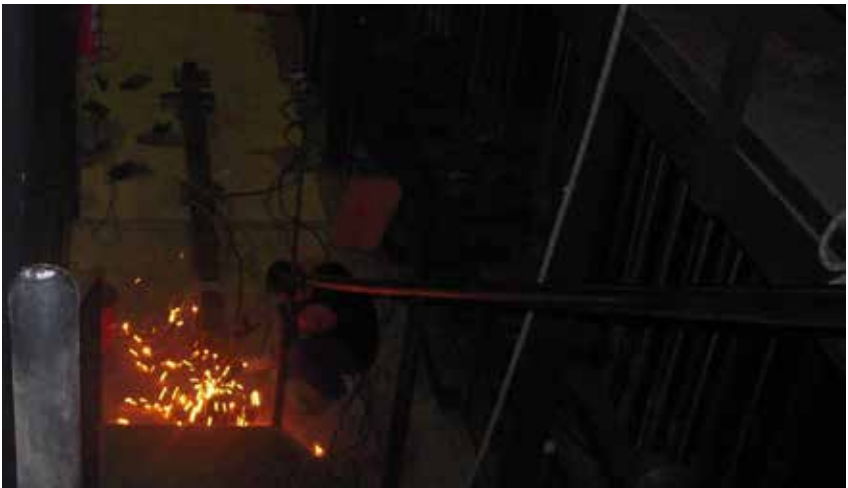
Obras no supervisadas de remodelación o mantenimiento del edificio del museo en las que se usan llamas abiertas o otras fuentes de calor o chispas representan un importante riesgo de incendio (Foto: José Luiz Pedersoli Jr.).
