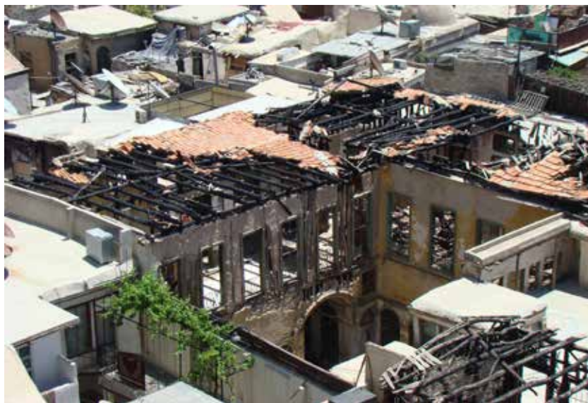
Edificio patrimonial dañado por el fuego (Foto: Firas Otman).
